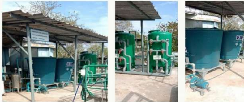
ภาพแสดงการติดตั้งถังกรองน้ำเพื่อนำน้ำกลับมาใช้
