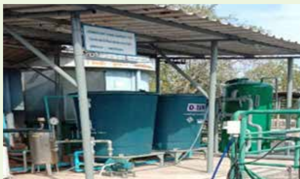
ภาพการติดตั้งระบบการนำน้ำทิ้งกลับมาใช้ใหม่ ภาพแสดงผลตรวจวิเคราะห์น้ำหลังบำบัด
